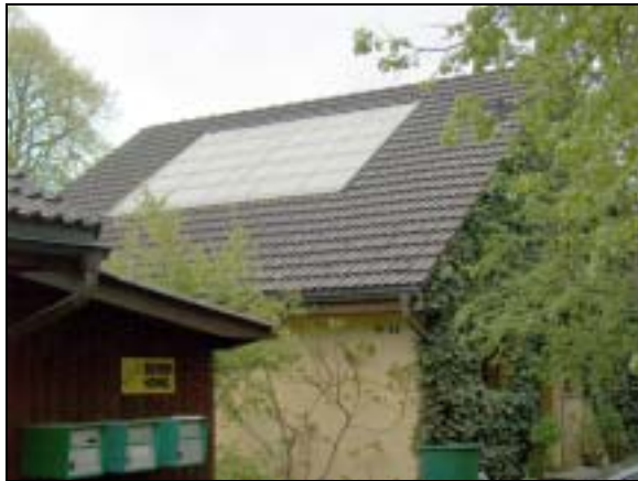
Sonnenkollektoren fürs Warmwasser an der Bolletstrasse in Mettmenstetten
