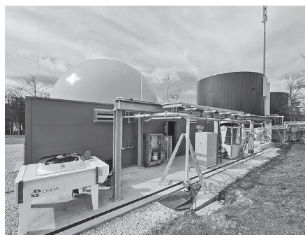
Die Biogasanlage in der ARA Schönau wurde im April eingeweiht.
