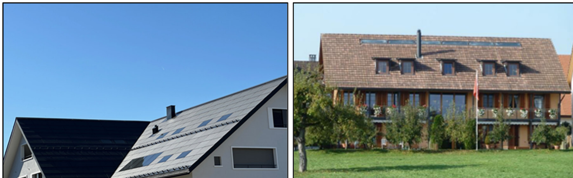
Abbildung 3, links: Flächenbündig integrierte Photovoltaik-Anlage (Indachsystem) mit eingelassenen Dachflächenfenstern
